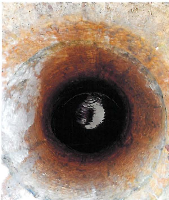
Água fluindo após o esgotamento do poço.
